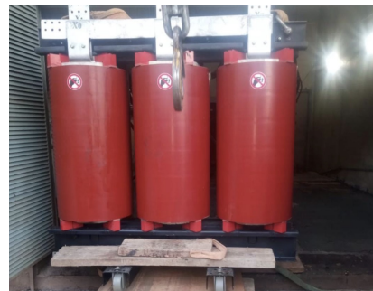
(b) Transformador após secagem e condicionamento.
