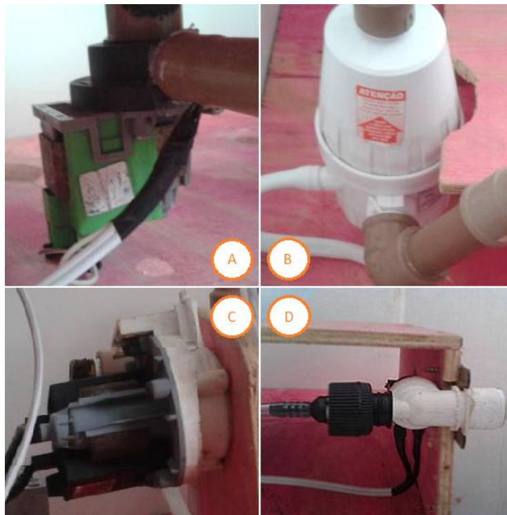
Figura 7. Bombas d'água (A, C), Aquecedor (B) e Registro Eletrônico (D)
