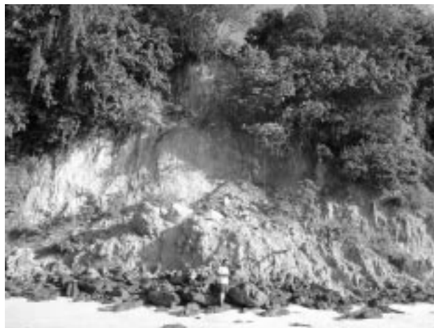
Figura 6 - Deslizamento no início do sub-trecho 2.
