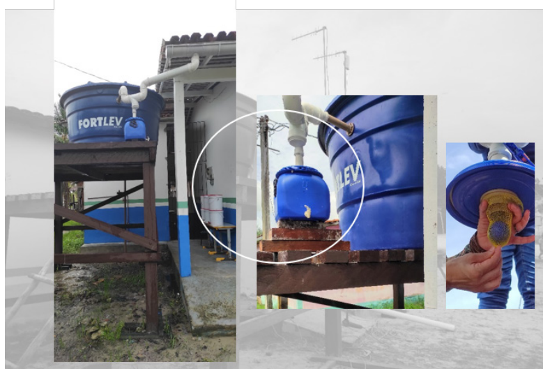
Figura 5 - Desvio das primeiras águas - SCAC Tamaruteua
